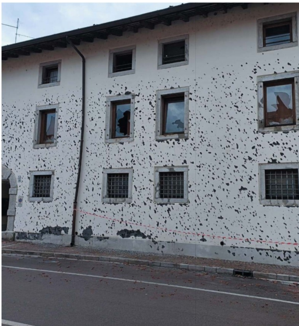
Il cappotto termico di un edificio bucherellato dalle violente grandinate che hanno colpito il Nord Italia negli ultimi giorni
