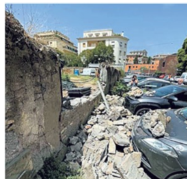
▲ Il crollo Il muro venuto giù con i lavori
