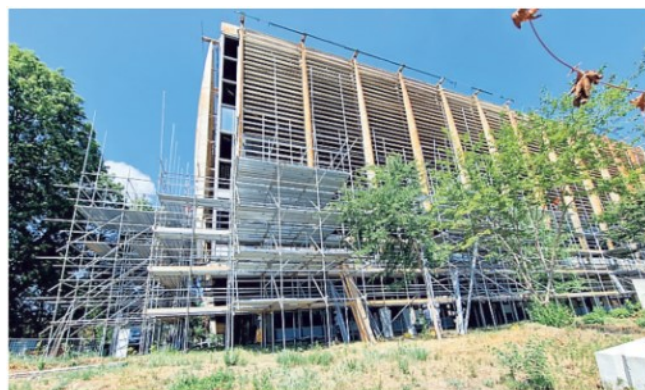
Palazzo del Lavoro all'ingresso della città è fatiscente e abbandonato
